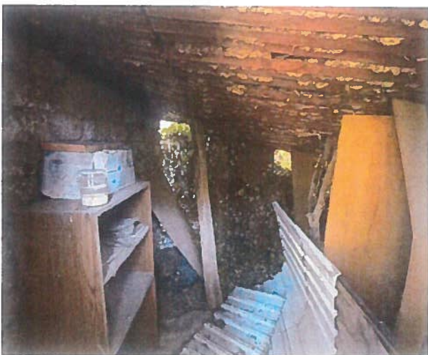
Melléképület leszakadt mennyezete
